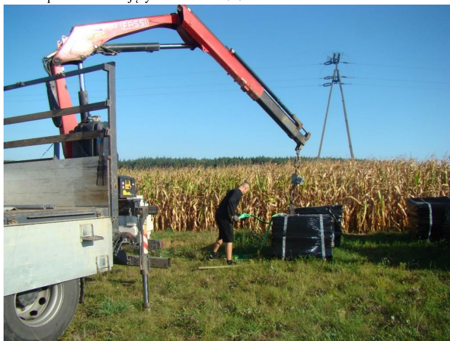
Zdjęcie 2 . Odbiór odpadów zawierających azbest w 2019r.
